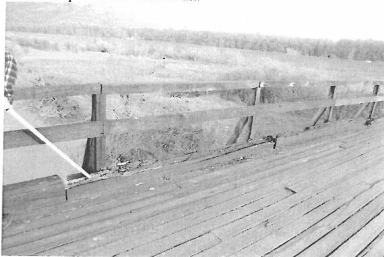
4. Bornă apără roată deteriorată
