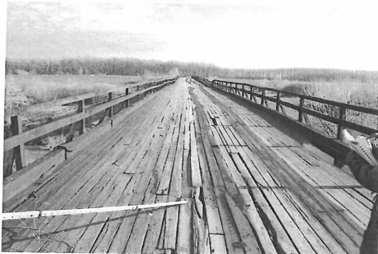
3. Podină de uzură deteriorată
