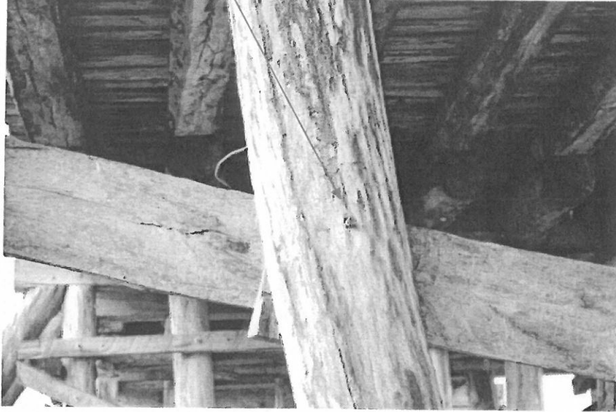
24. Lipsă șaibe și piulițe
